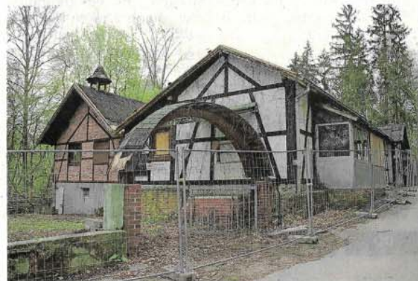
Sie ist weniger als ein Schatten ihrer selbst – die Waldschänke im Köpftal ist über die Jahre zur Ruine verfallen. Nun ist sie eingezäunt und bereit für den Abriss.
