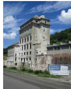
Das große Silogebäude des Gipswerks Neckarzimmern ist ein Stahlbetonskelettbau von etwa 1914/15. Foto: Sebastian Parzer, 2020
